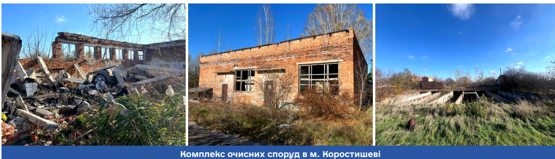
Комплекс очисних споруд в м. Коростишеві
